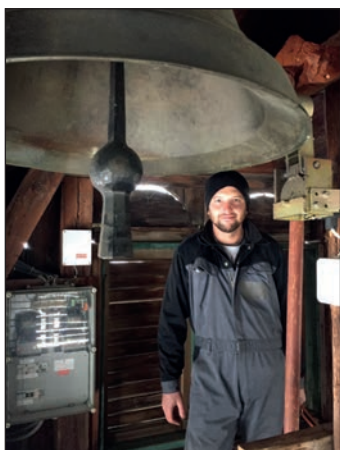
Überprüfung von Turmuhr und Glockenanlage in der Kulmkirche durch Herrn Schlemmer von der Firma Schauer & Sachs
